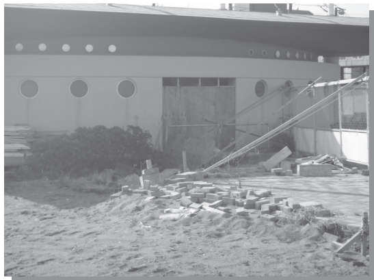
地震と津波で損壊した那珂湊漁港前のトイレ
